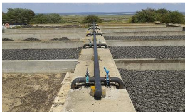
Fotografia 6: Vista geral dos leitos de secagem de lamas
